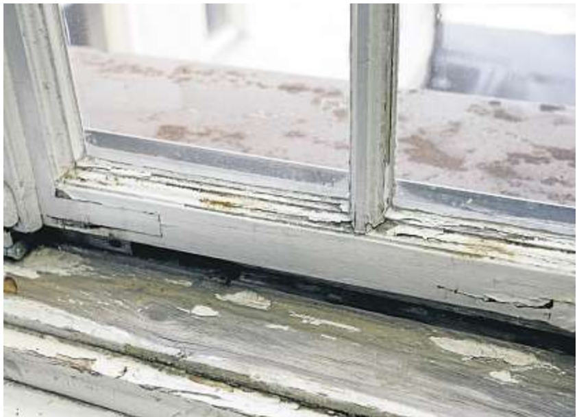
Nicht nur die Fenster bieten ein Bild des Jammers: Das Goethe-Gymnasium muss dringend saniert werden; gleich nach Ostern geht es los. Foto: MZ-Archiv
