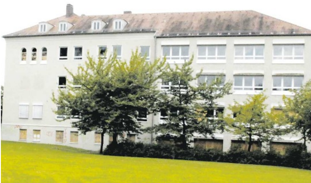
Das alte Krankenhaus in Regenstauf: „Der Zustand des Gebäudes entspricht quasi einem Rohbau. Wenn wir im Frühjahr anfangen, kann die Schule im Herbst 2012 starten“, so der Landrat.
